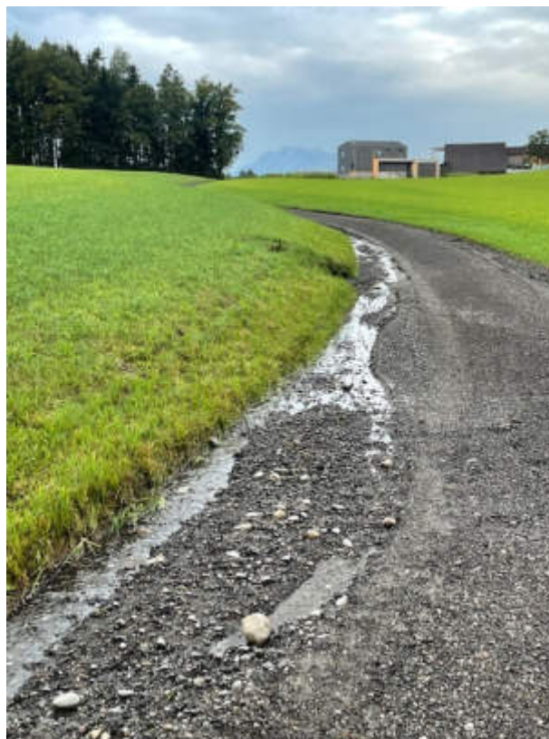
Zustand nach erneuten Stark-Niederschlägen
